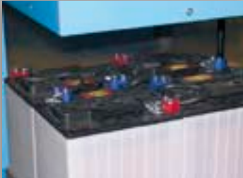
Gruppo batterie 24V. Unit batteries 24V.
